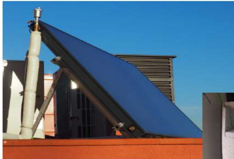
Panel solar térmico
