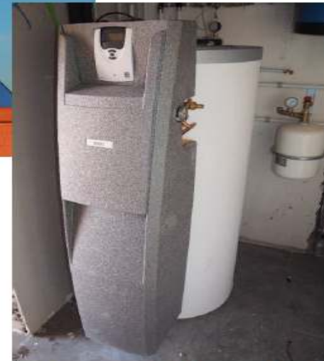
Acumulador del panel solar
