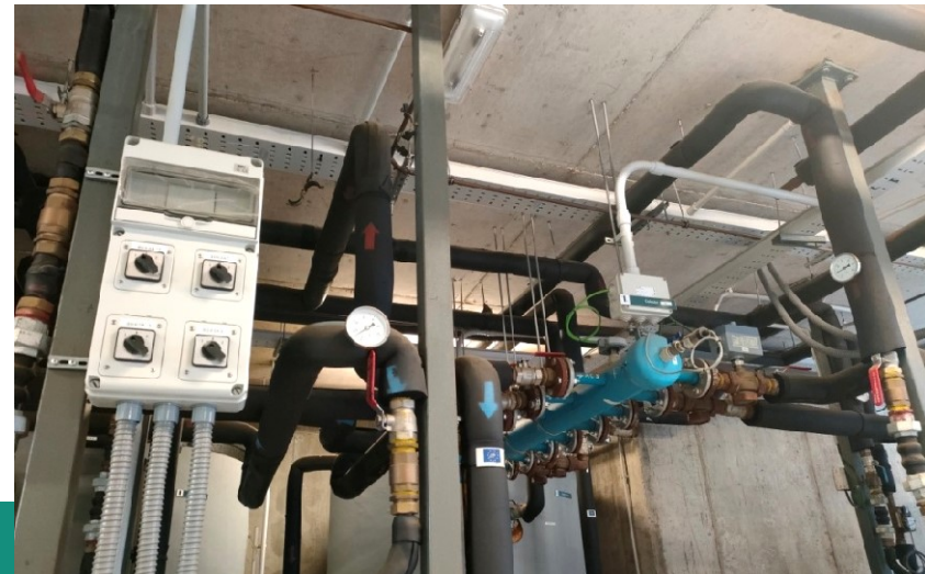
Red Hidráulica. Colectores
